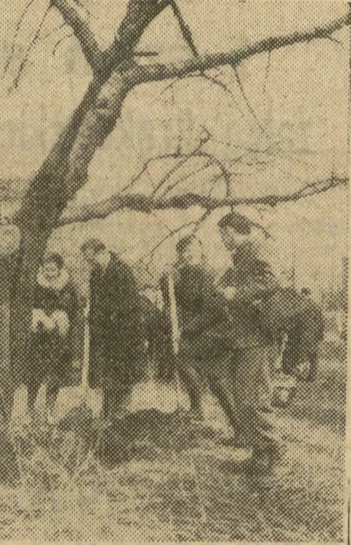
Wczoraj w Krakowie przy ul. Smoluchowskiego rozpoczęto przygotowania terenu pod budowę zespołu 5 budynków Wyższej Szkoły Pedagogicznej. Obiekt ten o łącznej kubaturze 80 tys. m sześciu, będzie się składał z pawilonu głównego, dwóch bocznych skrzydeł, auli i sali gimnastycznej. Nowy obiekt zaprojektował inż. St. Juszczyk z „Miastoprojektu”. Zespół budynków zostanie przekazany do użytku WSP w latach 1971/72. Wykonawcą tej inwestycji jest KPBM ZBM.
