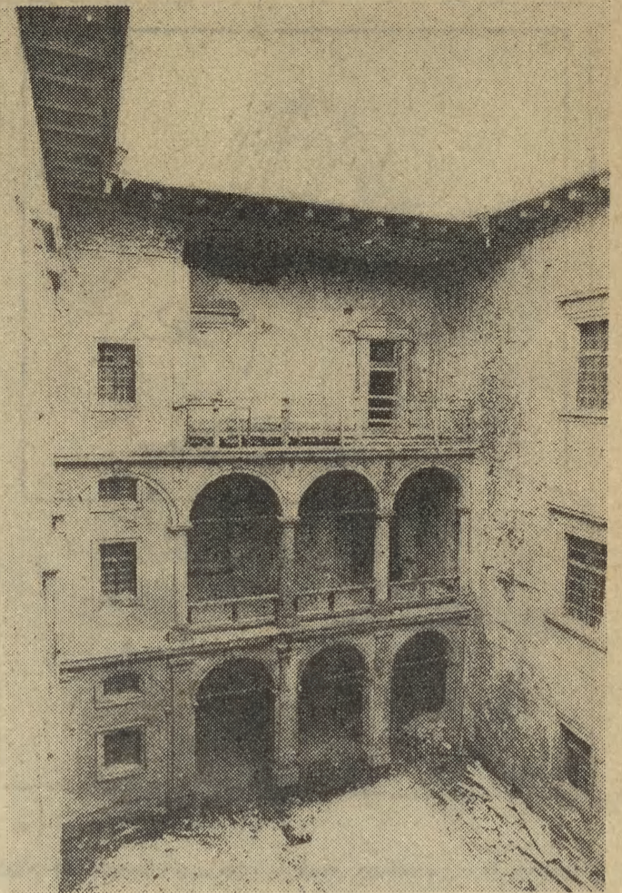
Zamek — fragment od strony dziedzińca nadal zalwany przez wody opadowe czeka na zalanie i dalsze prace remontowe.
