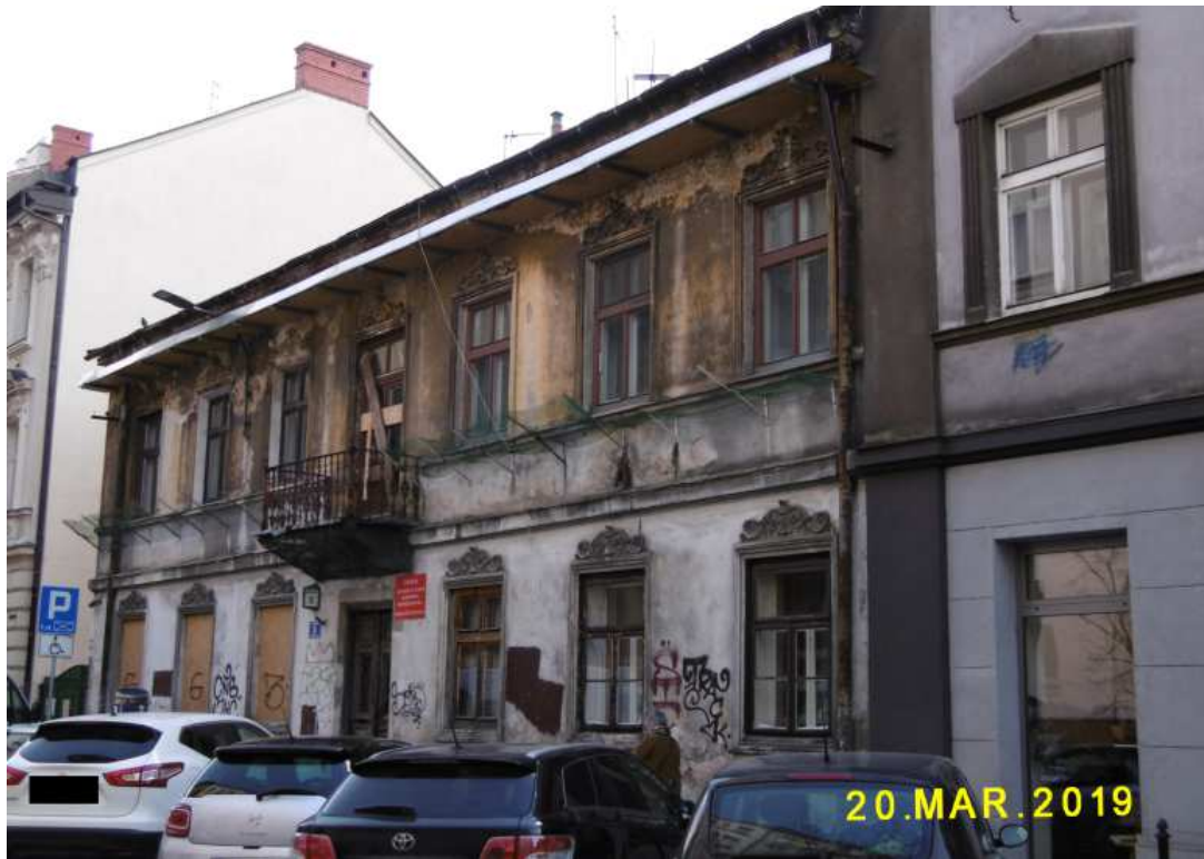
Fot. nr 173 (173-176). Zrujnowany, blisko 150-letni dom z ulicy Batorego 8 i jego dawne detale. Jak będzie wyglądał po remoncie bądź przebudowie?
