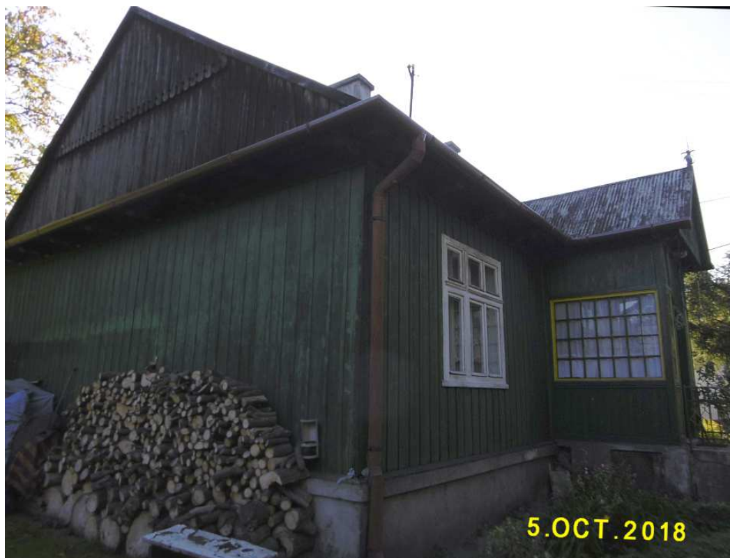
Fot. nr 231. Okno fasady, które nie jest już oryginalne.
