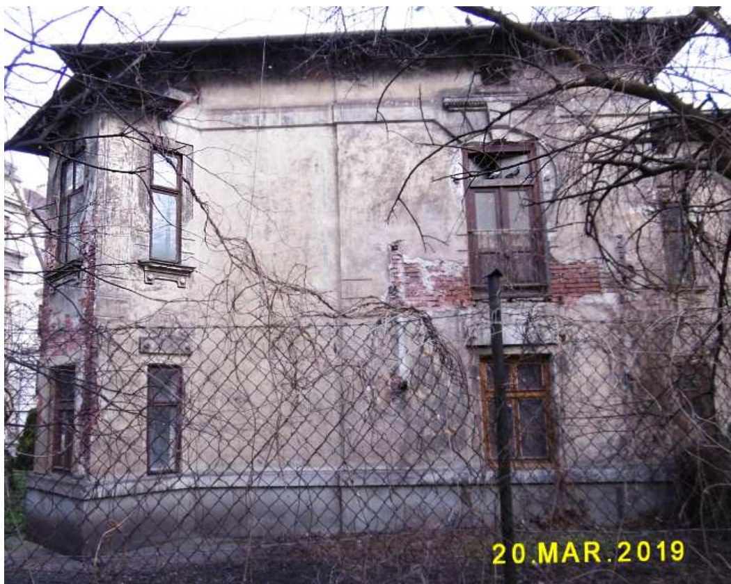
Fot. nr 163. Narożnik willi, w której mocno zniszczonym wykuszu zachowały się oryginalne okna na I piętrze.
