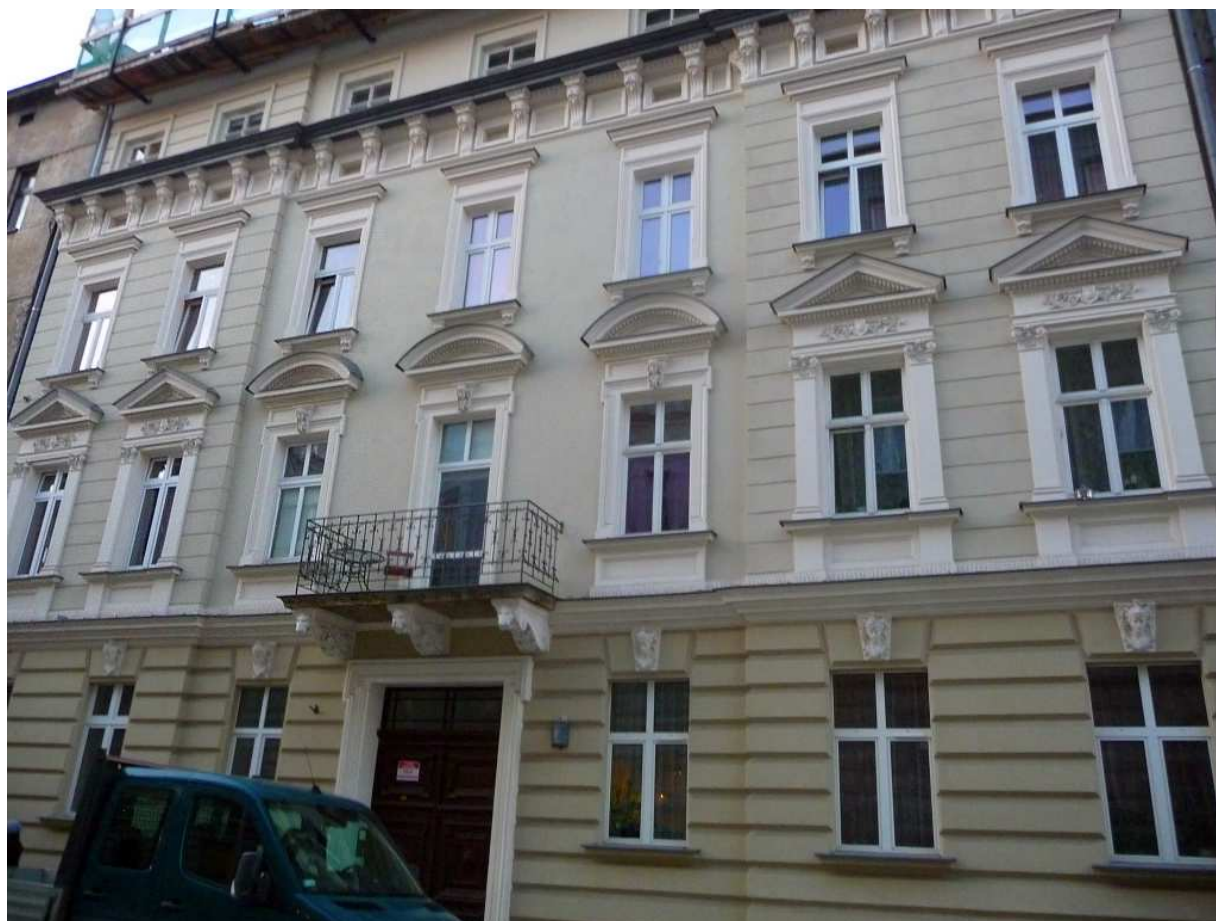
Fot. nr 137. Niechlujstwo przy doborze montażu okien może tu porażać. (19.02.2019)
