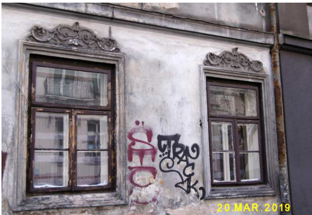
Fot. nr 176. Oryginalne okna sprzed około 100 lat w prawej części parteru.
