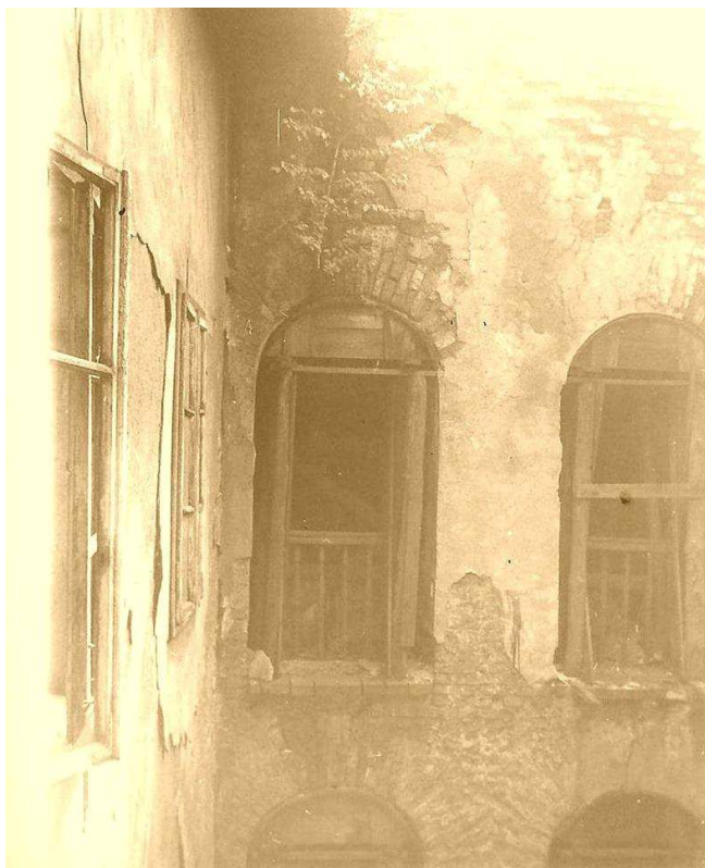
Fot. nr 16 (16-18). „(Te) zdjęcia to oficyna, całkowicie już zrujnowana. Na schody już nie było dostępu”. Opis S.M.
