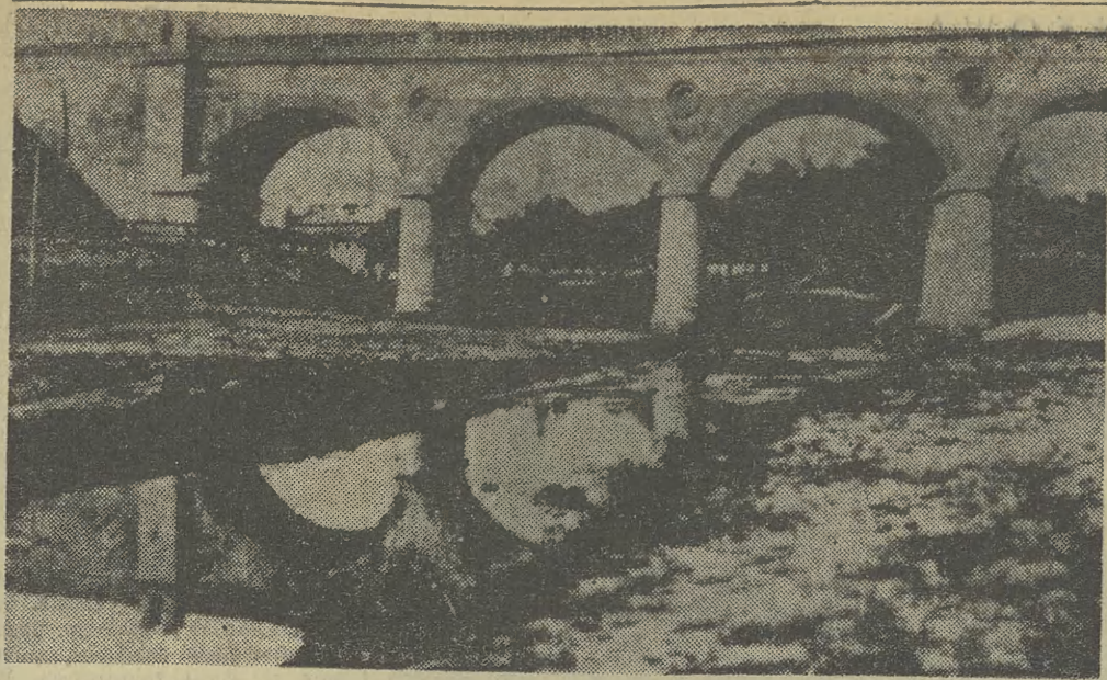
Zbudowany w 1863 r. most na Wiśle, dziś — wiadukt nad ulicą Grzegorzeczką. Ponad 100 lat temu zaplanowano go z takim rozmachem, że jeszcze dzisiaj może być przykładem bardziej udanego rozwiązania komunikacyjnego.
