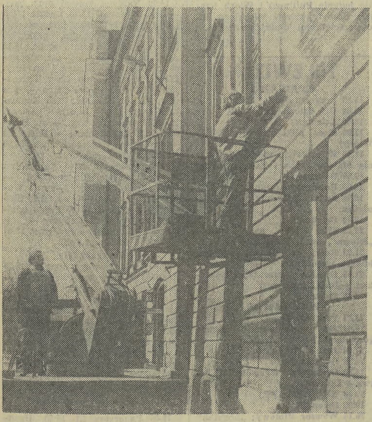
Z pomocą dźwigu skuwano wczoraj tylni na fasadzie gmachu Miejskiej Biblioteki Publicznej przy ul. Franciszkańskiej. Wydaje nam się, że tego rodzaju doraźne zabezpieczenia „wiosny nie czynią”. Fot. Jadwiga Rubiś
