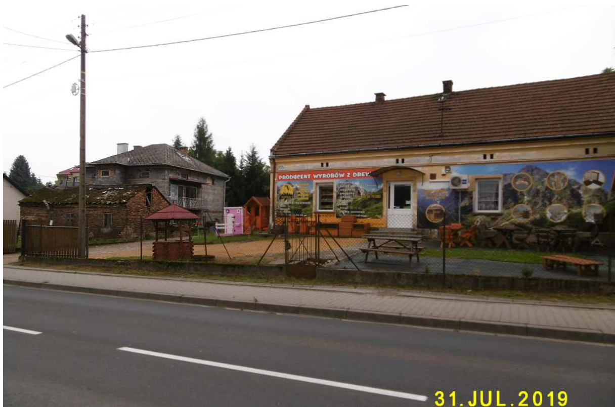
Fot. nr 37 (37-39). Ruina murowanego domu, zapewne przedwojennego, spod nr 54.
