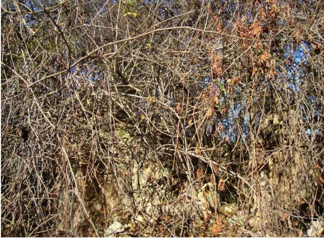
Fot. nr 191. Resztki murów budynku dworu pochłonięte przez zarośla.
