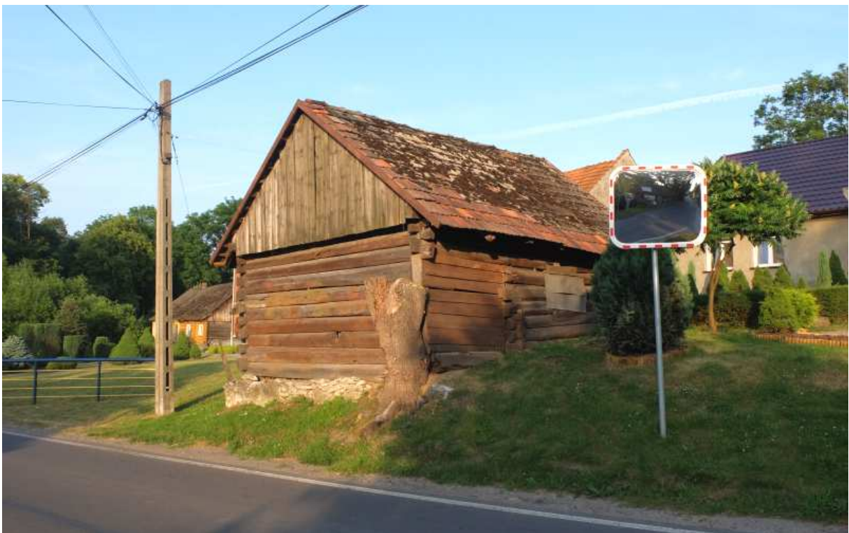
Fot. nr 107 (107-110). Kilka ujęć spichlerza i jego detali; obiekt zlokalizowany na cyplu pomiędzy kościołem i domami pod nr: 223 i 263 (w tle).
