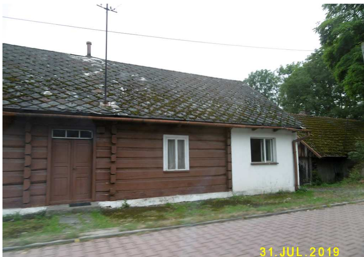
Fot. nr 75. Fragment częściowo rozbudowanej chałupy spod nr 110. Okno nieoryginalne. Fotografia L. Grabowski z za szyby jadącego samochodu
