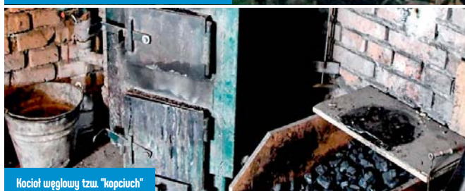
Szkodliwa emisja zanieczyszczeń do środowiska
