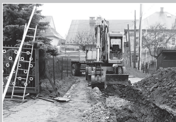
Sułkowice. Pomimo zimy V etap prac kanalizacyjnych jest kontynuowany. Obecnie w okolicach ul. Na Węgry pracują dwie brygady.
