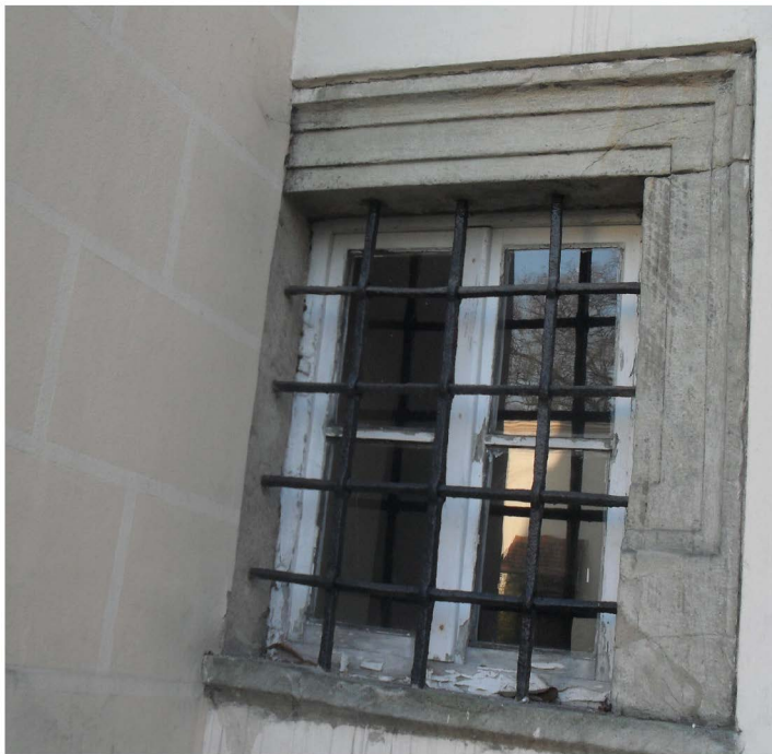
Sucha, wschodnia część południowego skrzydła zamkowego: szkarpa przesłaniająca wtórnie renesansowe obramienie okienne; fot. autor
