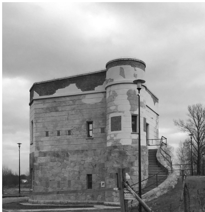
Ufortyfikowana strażnica kolejowa – Tryńcza „Most Wiśłok” – podczas prac remontowych i rewitalizacyjnych. Widok od strony narożnej baszty, czytelne zróżnicowane wielkościotworów okiennych i strzelniczych. Fot. F. Suchoń, 2018
