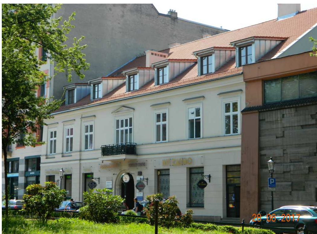
Fot. nr 254. Kamienica spod nr 3, gdzie nie zostały zachowane dawne ośmiopolowe okna.
