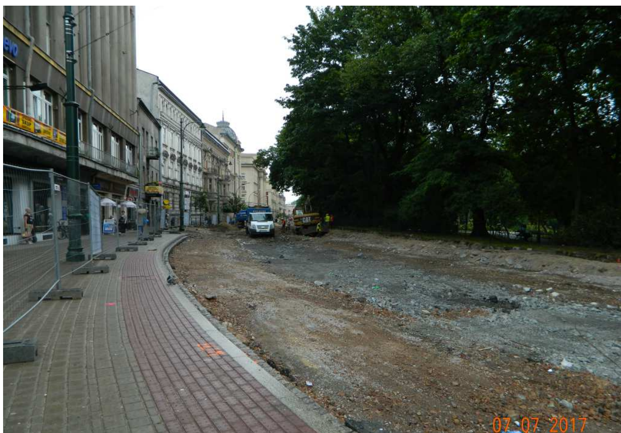
Fot. nr 256. Remont ulicy Basztowej, który miał trwać do grudnia tego roku. Tu odcinek od Rynku Kleparskiego.
