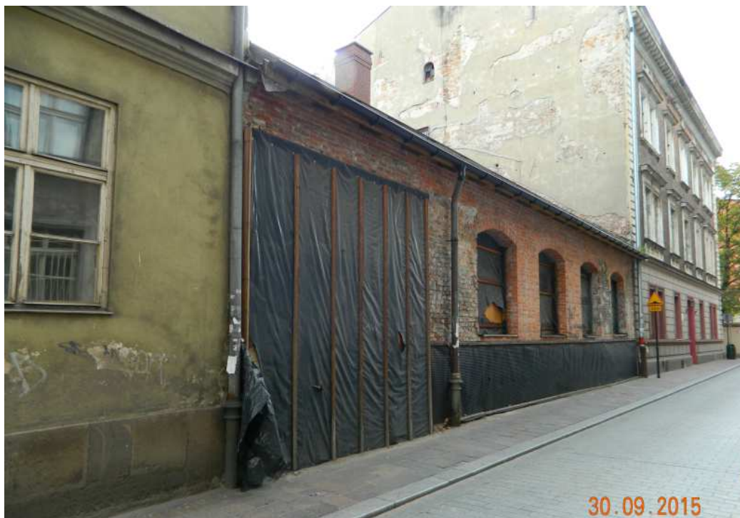
Fot. nr 44. Opornie postępuje remont dawnej kuźni Zieleniewskich z ulicy św. Marka 31. Tu jej widok od strony ulicy św. Krzyża (nr 12).
