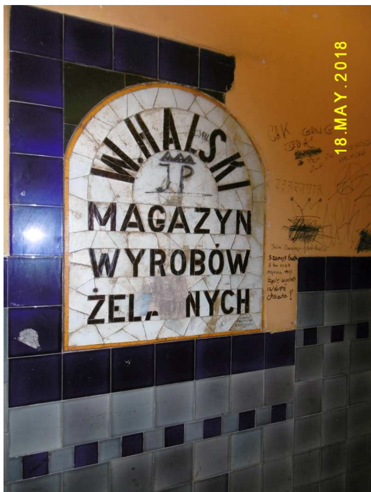
Fot. nr 371 (371-372). Oryginalne płytki sieni kamienicy z ulicy Szewskiej 23, które są w coraz gorszym stanie.
