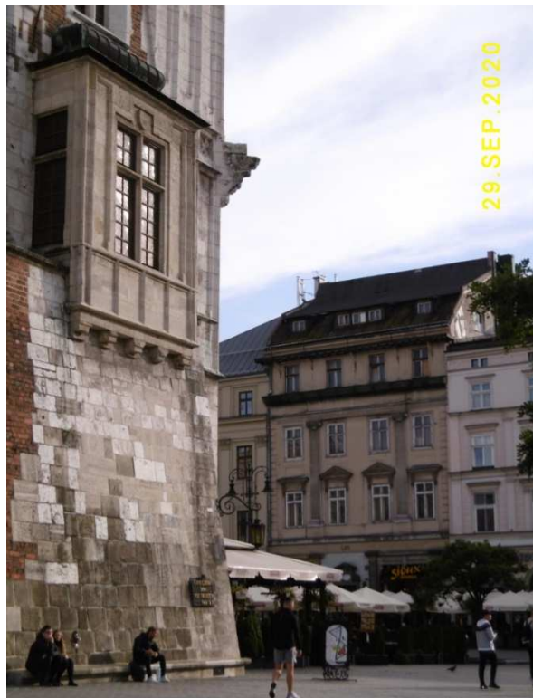
Fot. nr 32. Ciągłe zaniedbana kamienica pod nr 22.
