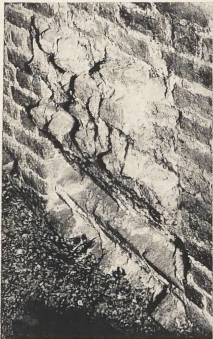
38. Sztraby na północnej ścianie muru nawy południowej na strychu Fot. P. Maliszewski
