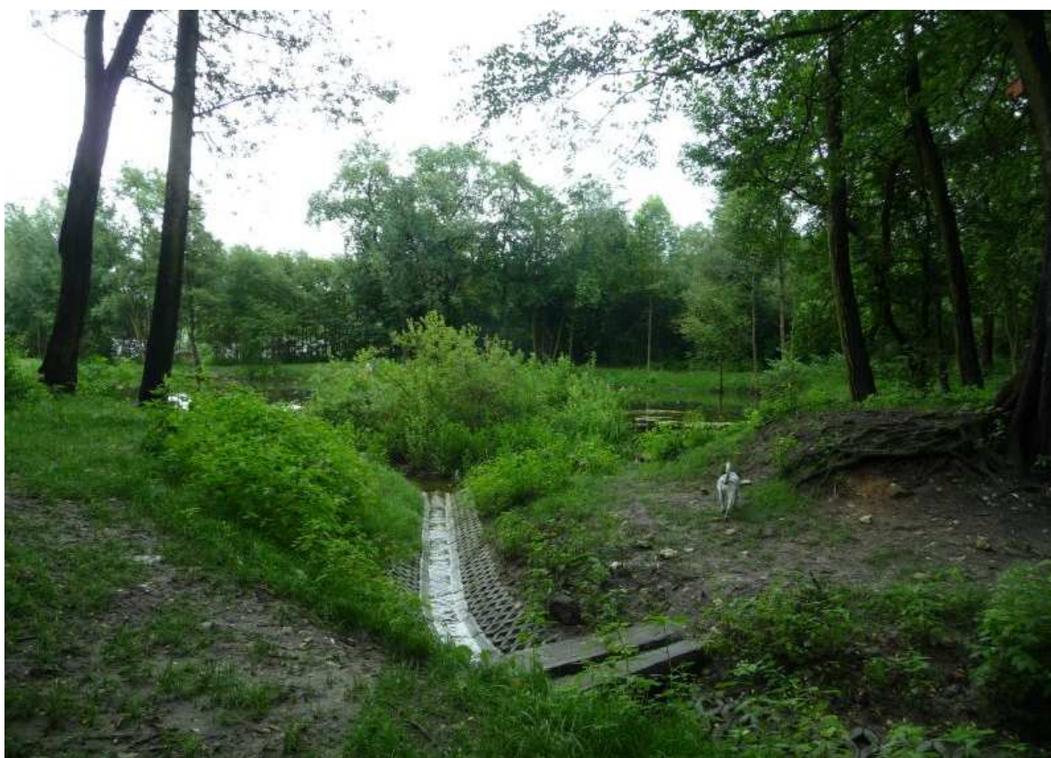
Fot. nr 56. Kanał ściekowy wpadający prosto do stawu. (26.06.13)
