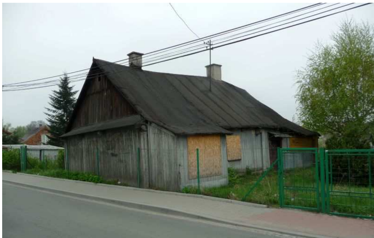
Fot. nr 76 (76-77). Dogorywająca, wiejska chałupa z ulicy Ściegienego 12. (30.04.13)
