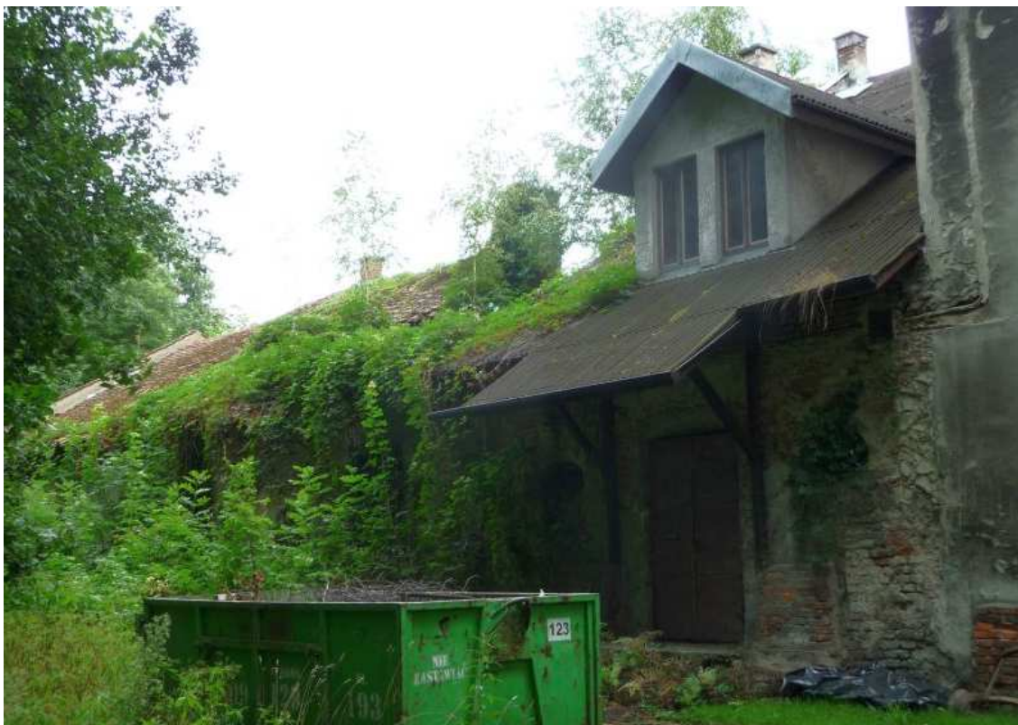
Fot. nr 48(48-49). Ruina zabudowań gospodarczych przylegających do dworu. (14.08.13)
