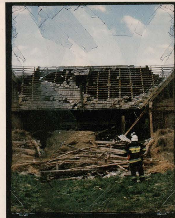
Trąba powietrzna przeszła przez Podhale. Żywiol niszczył dom w 10 sekund. W podobny sposób przestało istnieć ponad sto budynków. Strażacy dziwili się, że nie było ofiar.
