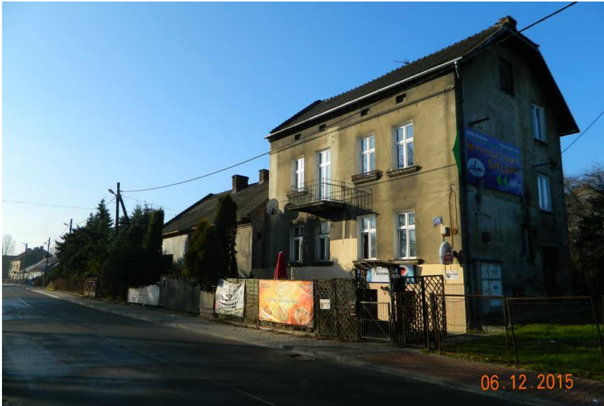
Fot. nr 44. Zapewne przedwojenna kamienica spod nr 53a, już z plastikowymi oknami.
