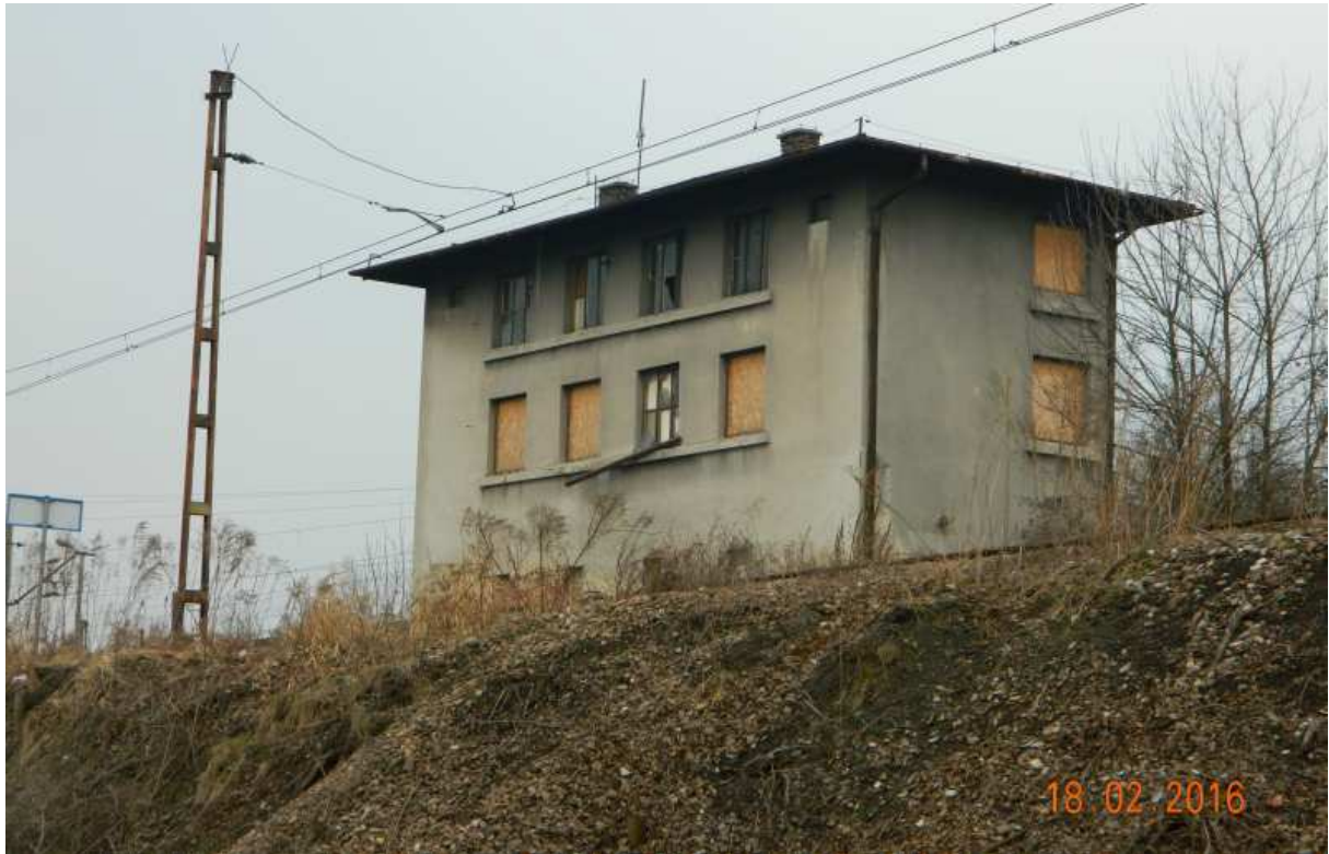
Fot. nr 93. Zrujnowany budynek przy stacji rozrządowej w Prokocimiu.
