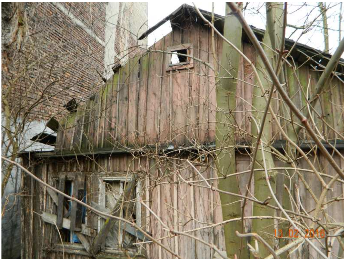
Fot. nr 133. Boczna ściana domu spod nr 59.
