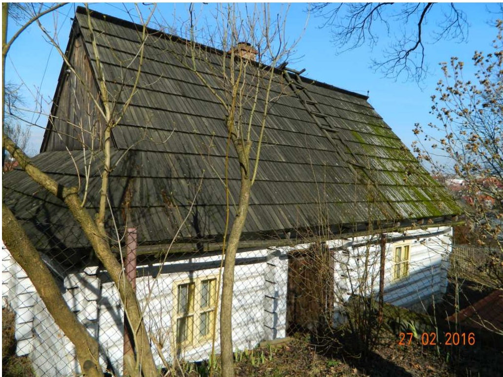
Fot. nr 23. Zrekonstruowany kilka dekad temu, dom grabarze na cmentarzu przy kościele św. Salwatora (XIX w.). Niestety na dachu z gontu pojawiła się dziura, znaczone mchem.
