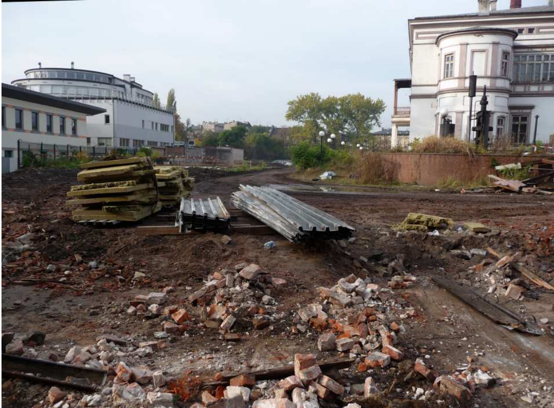
Fot. nr 228 (226-267). Krakowski Browar z ulicy Lubicz 17 na etapie burzenia. W miejscu tego historycznego obiektu, liczącego ponad 150 lat, wkrótce miało powstać gęste blokowisko mieszkalne. (27.10.2011)
