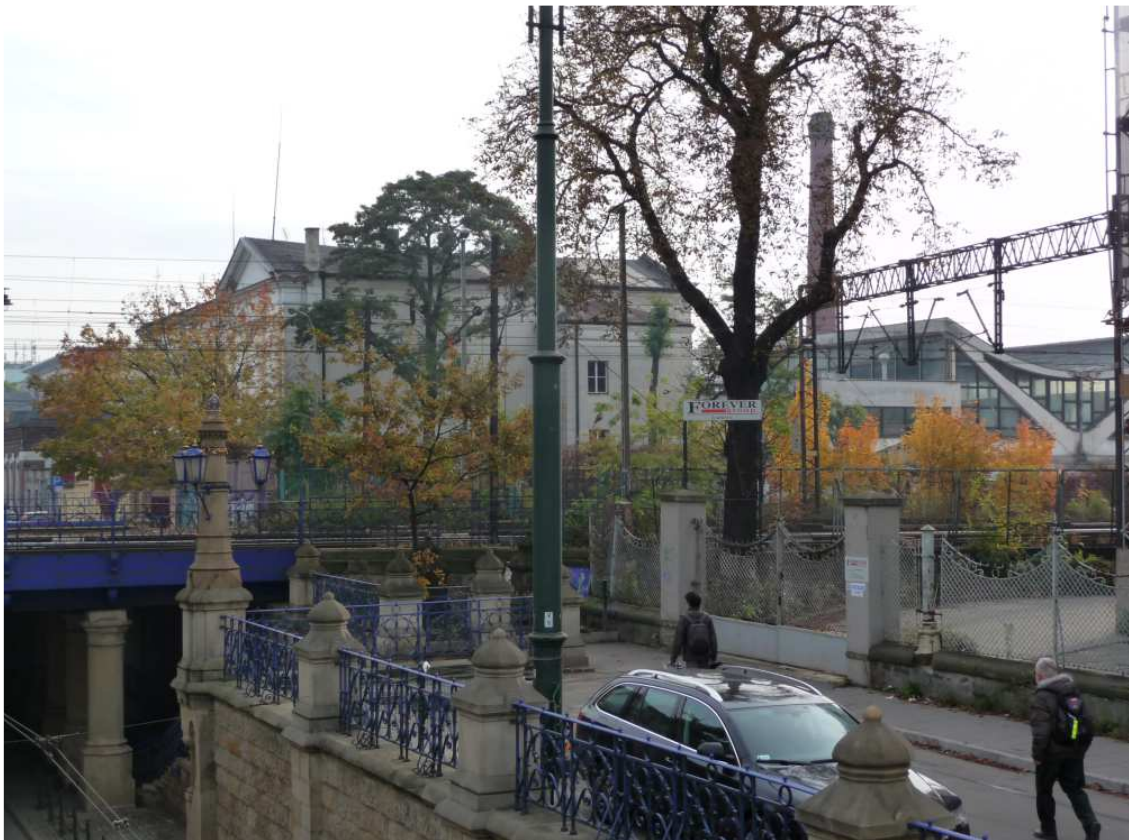
Fot. nr 269. Ostatnie spojrzenie na burzony właśnie browar ponad wiaduktem kolejowym, który powstał nad ul. Lubicz w roku 1898 wg projektu Teodora Talowskiego. (27.10.2011)
