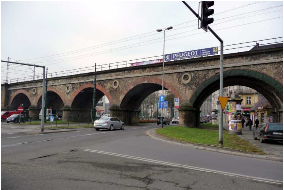
Fot. nr 70. Wiadukt kolejowy na styku ulic: Dietla i Grzegórzeckiej, wybudowany nad korytem starej Wisły w latach 1861-63, wg projektu Leona Mikuckiego. (27.10.2011)
