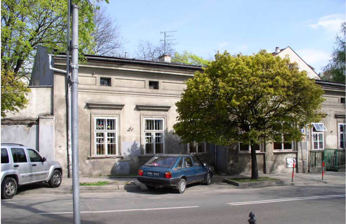
Fot. nr 138 (138-141). Budynek dawnego lazaretu przy kościele św. Mikołaja, pochodzący z okolic połowy XIX wieku; dziś mieści się tu przedszkole nr 1. Tu stan fasady przed remontu. (17.04.2009)
