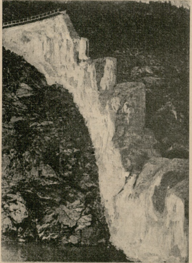
Ryc. 7. Zapora Malpasset — prawy przyczółek po katastrofie
