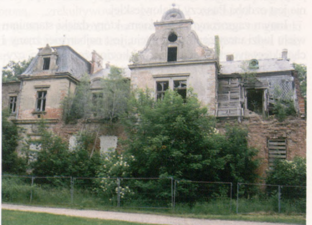
Ryc. 3. Zrujnowany pałac. Fot. K. Mazurski
