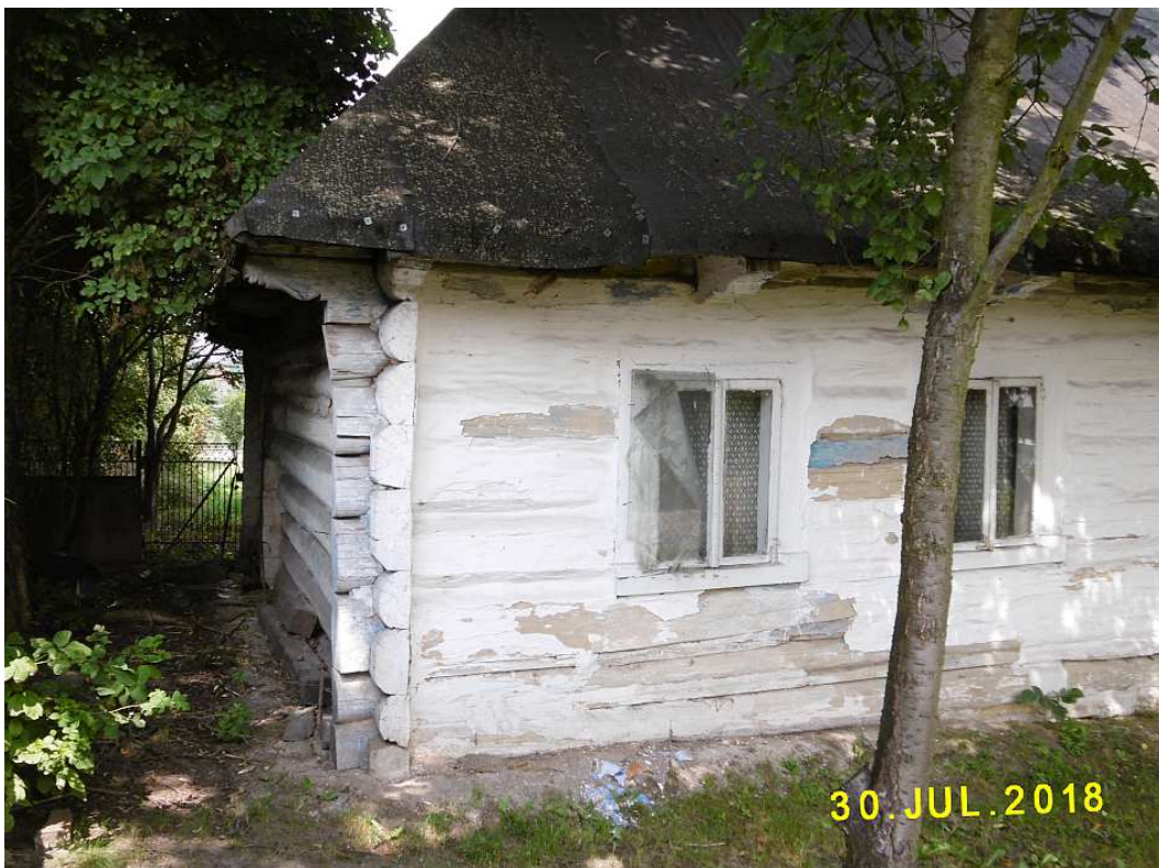
Fot. nr 81. Lewy narożnik fasady od strony ogrodu i nieoryginalne już okna.
