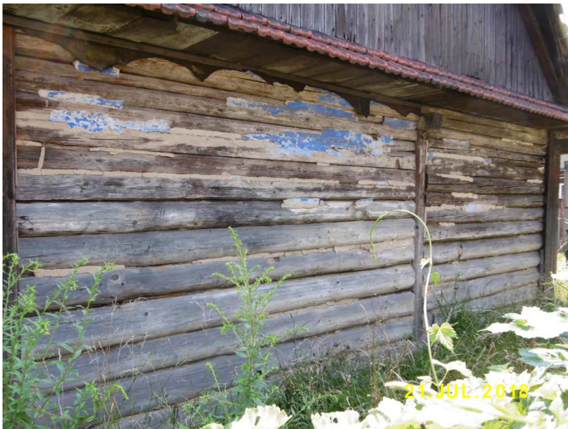
Fot. nr 136. Ślady dawnego bielienia na bocznej ścianie.
