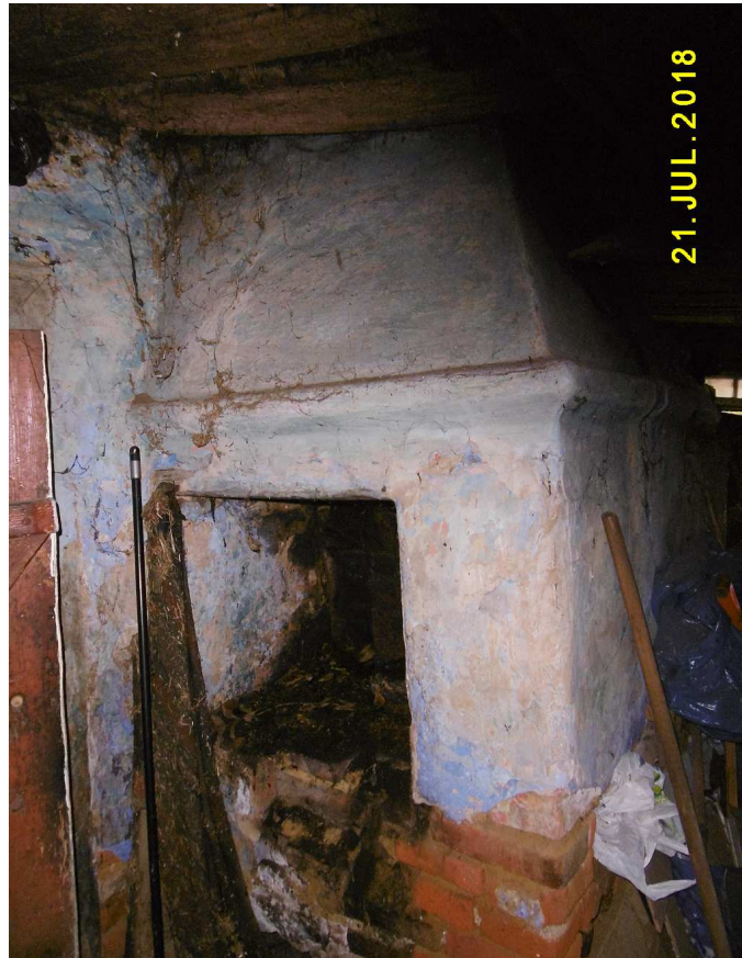
Fot. nr 116. Piec w sieni przelotowej.
