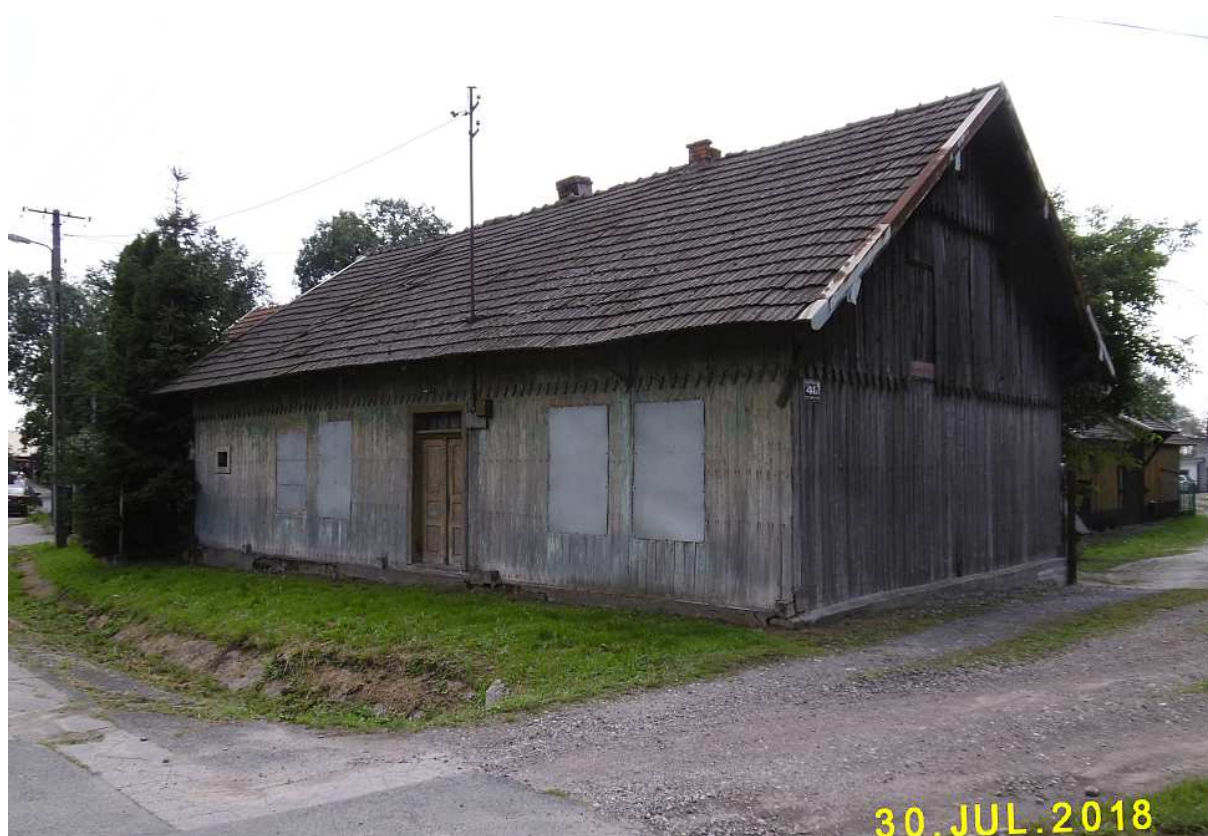
Fot. nr 129. Widok fasady, gdzie już niestety nie ma okien.
