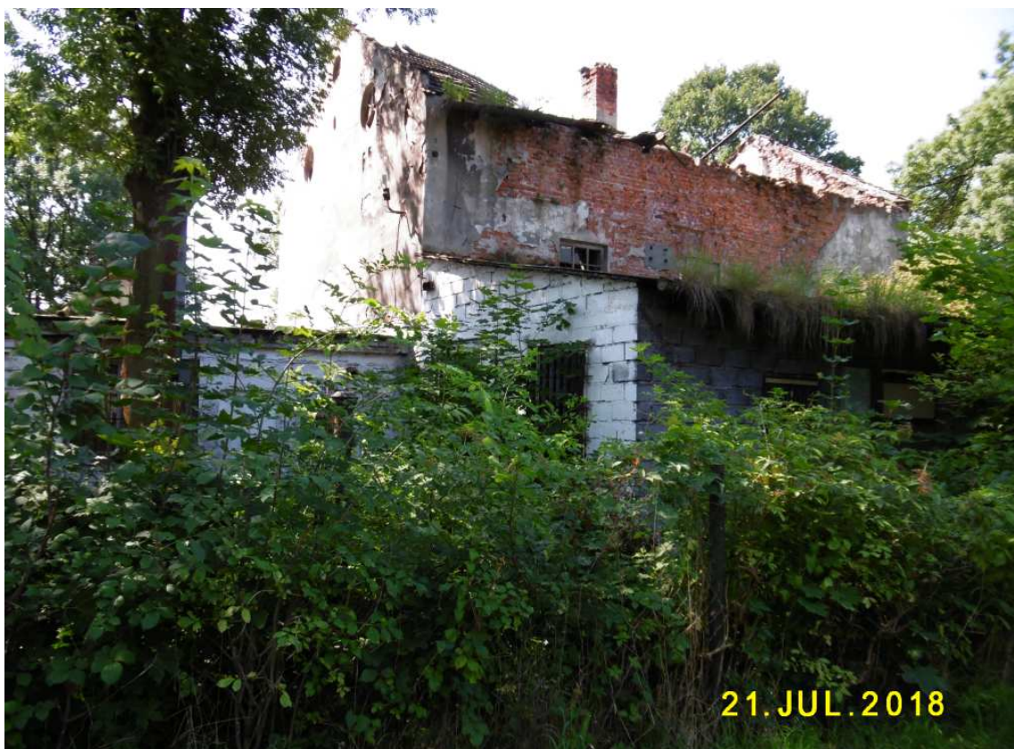
Fot. nr 94. Ruina dawnego młyna Lelity przy ulicy Stare Wiślisko 40.
