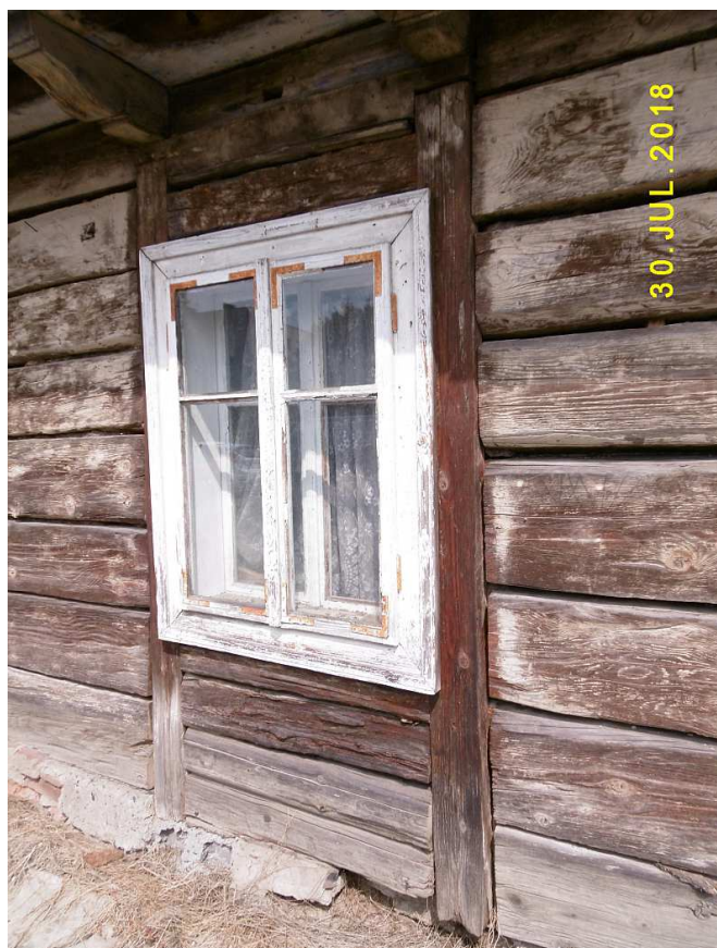
Fot. nr 57. Środkowe okno fasady w miejscu dawnych drzwi wiodących do ogrodu.
