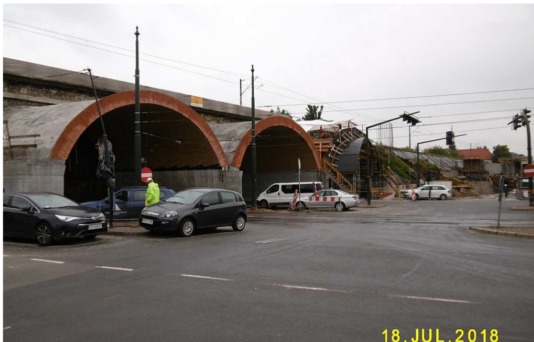
Fot. nr 37. Trwa rozbudowa zabytkowego wiaduktu kolejowego z roku 1863 nad ulicą Grzegórzecką.
