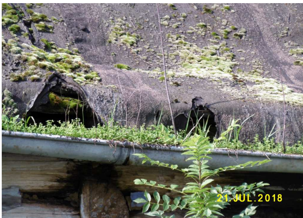
Fot. nr 123. Dziura w dachu, która szybko przyspiesza stan gnicia drewna.
