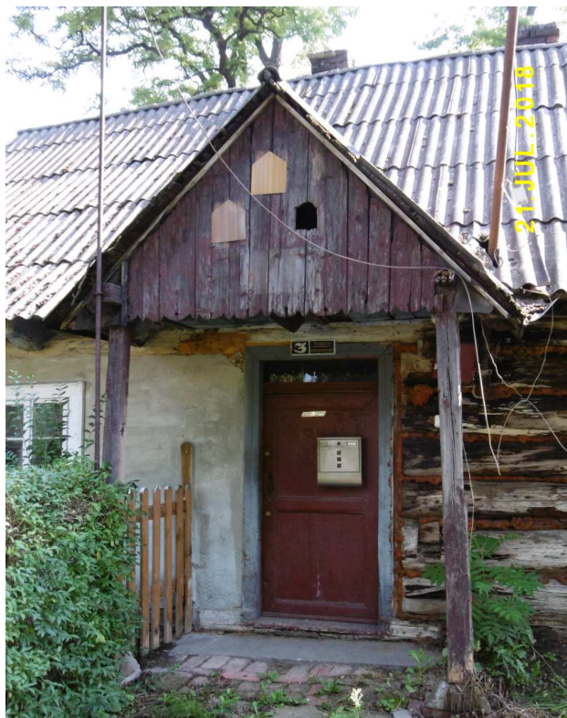
Fot. nr 57. Ganek w części środkowej. Z prawej strony za sprawą dziurawego dachu widać przegnite już belki.
