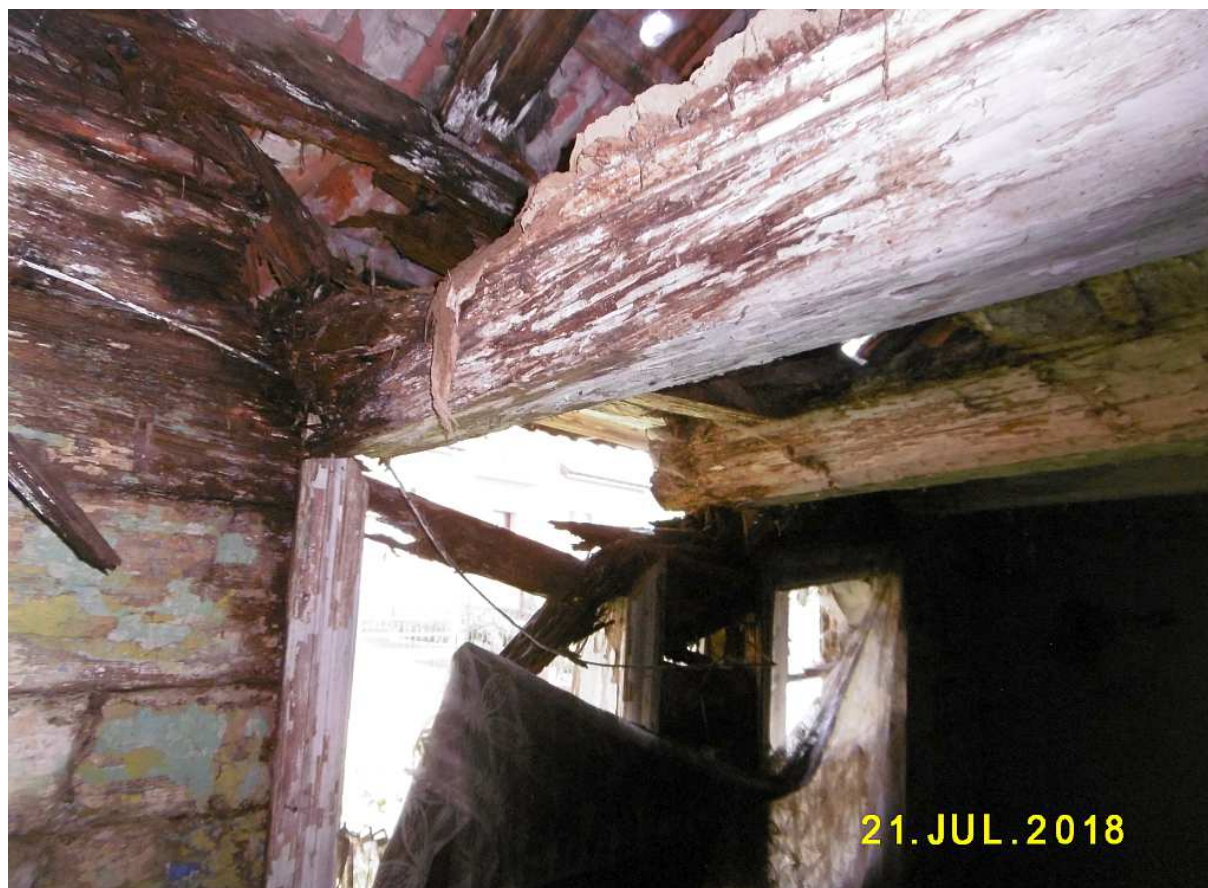
Fot. nr 90. Przegnity fragment izby w części od strony podwórka.
