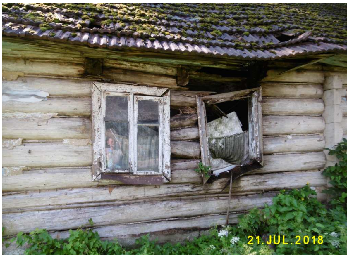
Fot. nr 75 (75-78). Detale części chałupy od strony podwórka. Tu Częściowo przegnity fragment ściany z lewej jej części.
