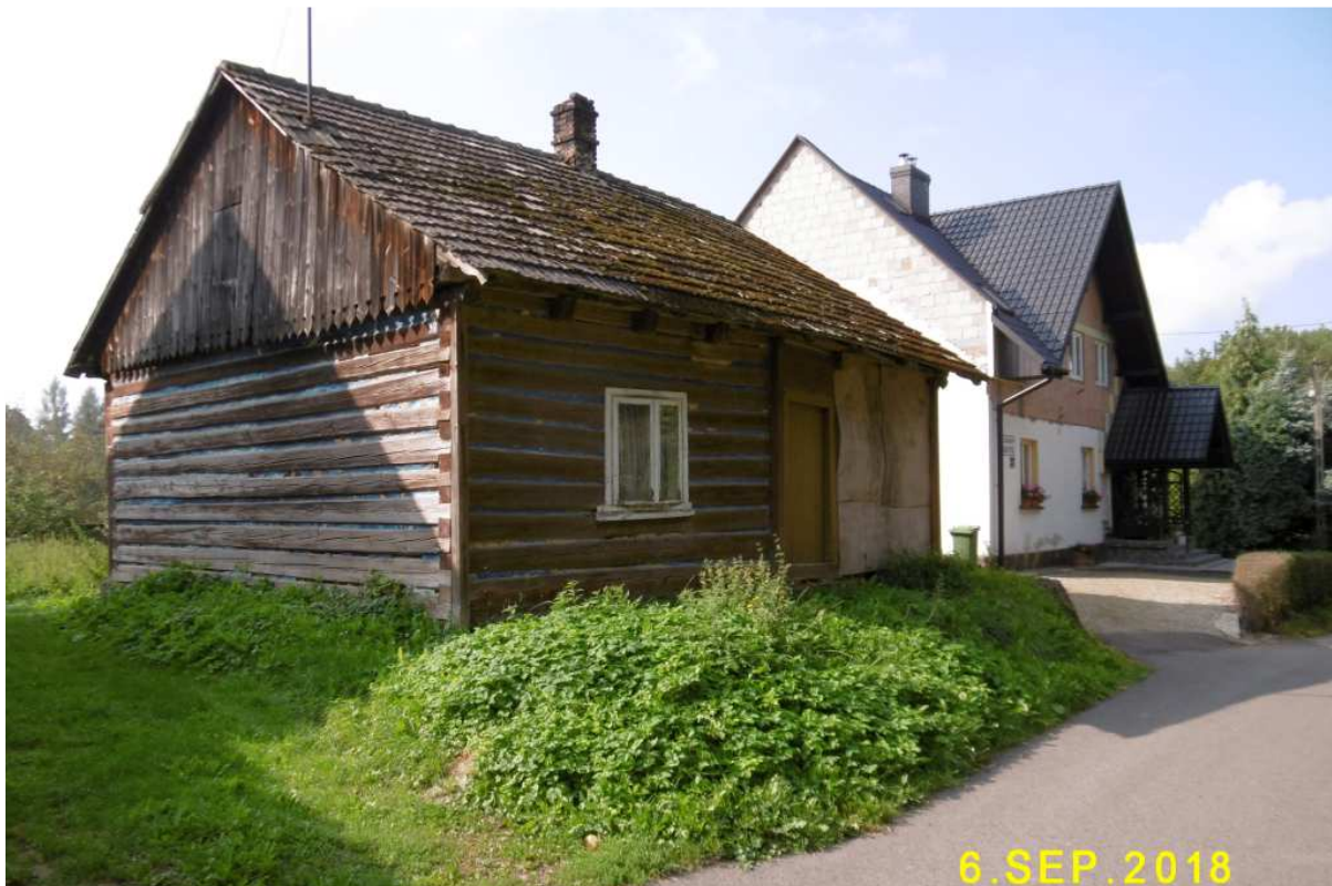
Fot. nr 30 (30-39). Skromna chałupa pod nr 38, którą można datować na przełom XIX i XX wieku. Fot. nr: 30-32 – ujęcia od strony ulicy.
