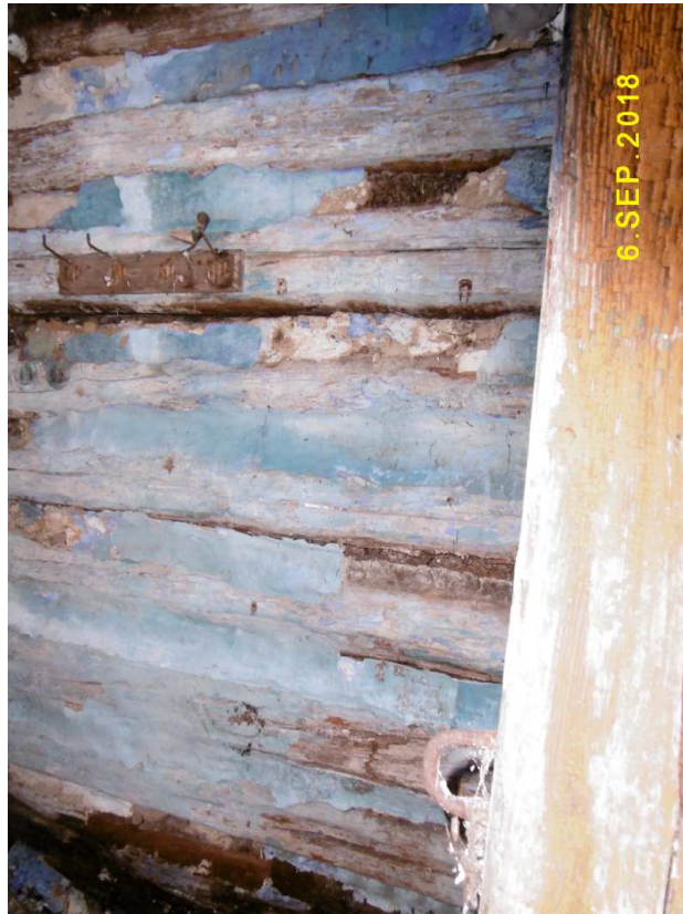
Fot. nr 9 (9-14). Kilka ujęć z przegnitego wnętrza. Tu resztki dawnego bielenia sieni.
