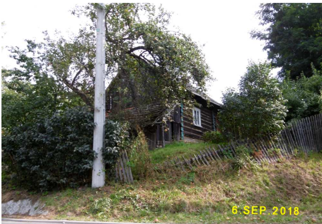
Fot. nr 40 (40-48). Chałupa pod nr 40, pochodząca zapewne z okolic przełomu XIX i XX wieku. Jej stan ogólny jest dobry. Fot. nr: 40-44 – fasada i jej detale od strony ogrodu.
