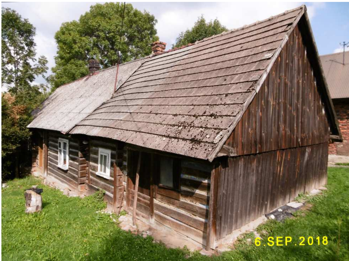
Fot. nr 18 (18-23). Chałupa pod nr 57, która mogła powstać pod koniec XIX wieku. Jej stan ogólny jest dobry. Tu jej widok z 01.03.2015.
