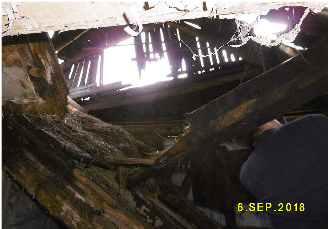
Fot. nr 13 (13-14). Wewnątrz zrujnowanej stajni.
