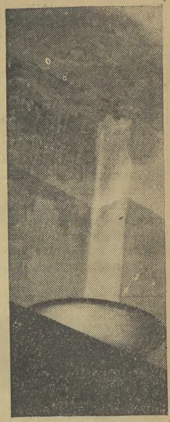
się im na głowy z sufitu. Leżące zaś w 18-zeczku dziecko trzeba było zabezpieczyć przed „wewnętrznym deszczem” — parasolem. Jak mówią eksperci budownictwa strop przecieka, bo został zbudowany z nieodpowiedniego materiału. Nawrwać go można, ale kosztem... całkowitej wymiany stropów czyli dodatkowe wielotysięczne, a może sięgające milionów złotych nadprogramowe wyzucenie spódnego piętrowego do błota. Inwestor tzn. Nowa Huta Kombinat winna bezwzględnie pociągnąć do odpowiedzialności karno-sądowej niedbałego wykonawcę. Fot. J. Lewicki
